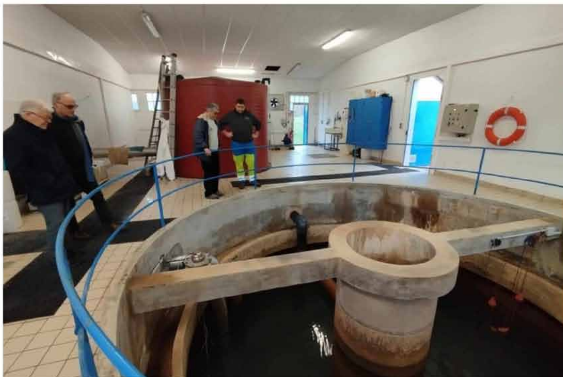
La station de pompage sera accessible aux visites. ©Joffrey Fodimbi
